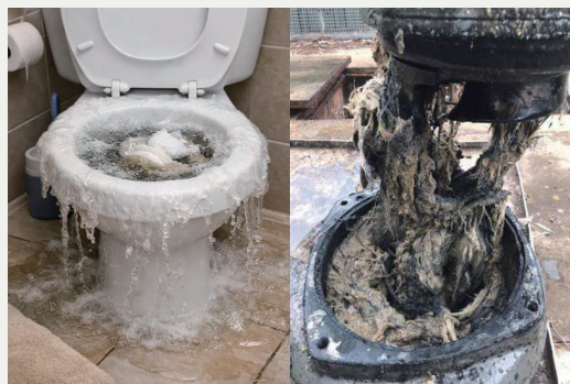
馬桶未確實減污減量 造成馬桶及糞管堵塞，無法正常使用
