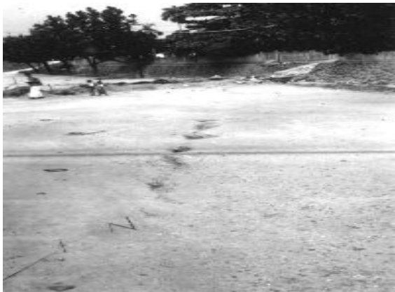
花蓮市明禮國民學校旁馬路上之地裂，走向呈N10°W，寬30公分。校內水泥場地地裂呈N40°W走向，一棟木造教室(長36公尺，寬9公尺)全倒。
