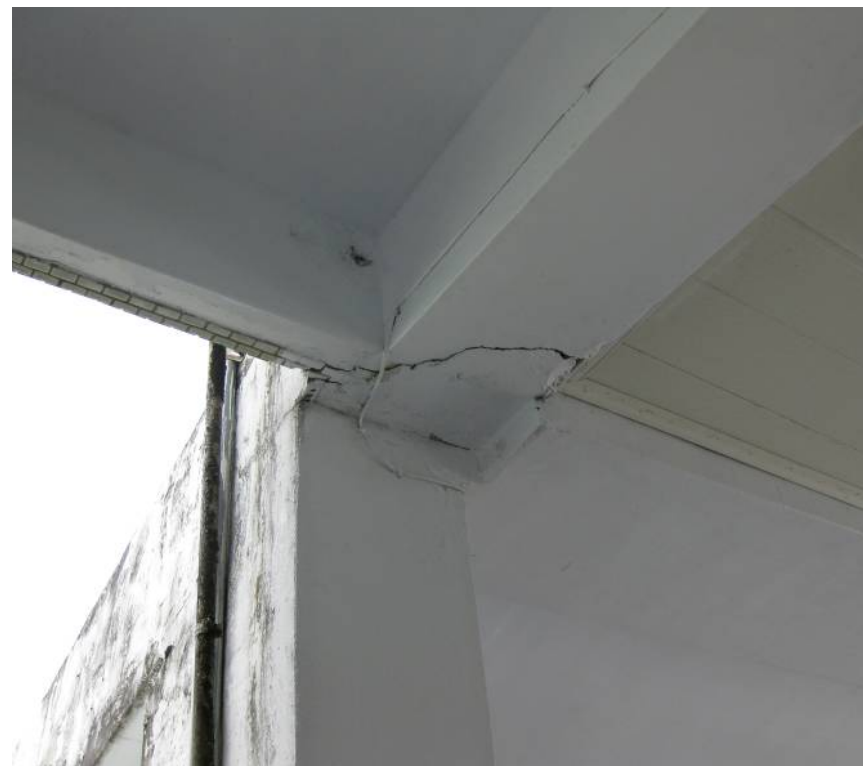
懸臂走廊梁端碰撞樓梯而造成開裂
