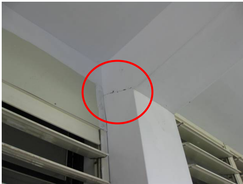
部分梁柱接頭輕微開裂
