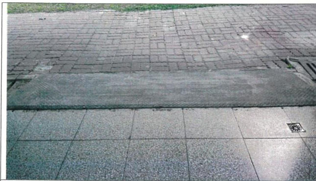
走廊與外面道路連接處落差太大
