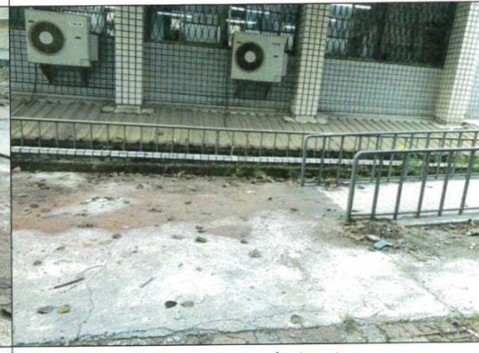
圖五：舊有無障礙坡道出口處地面狀況。
