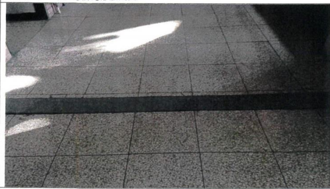
伸縮縫遮蓋的鐵板突出，致使輪椅不方便通過
