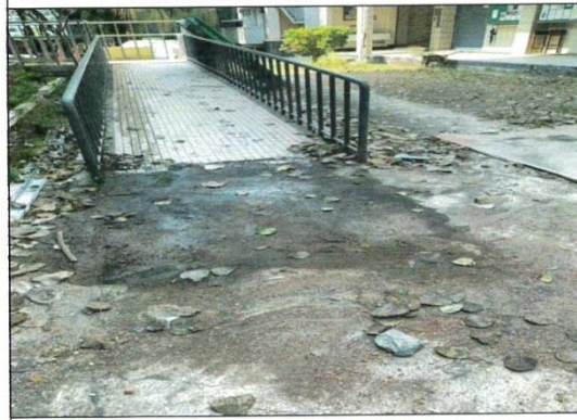
圖四：舊有無障礙坡道出口處容易積水。
