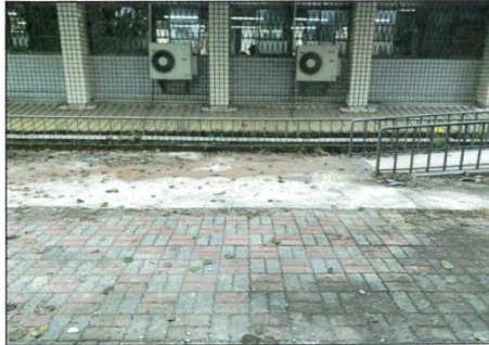
圖六：舊有無障礙坡道出口處地面狀況。
